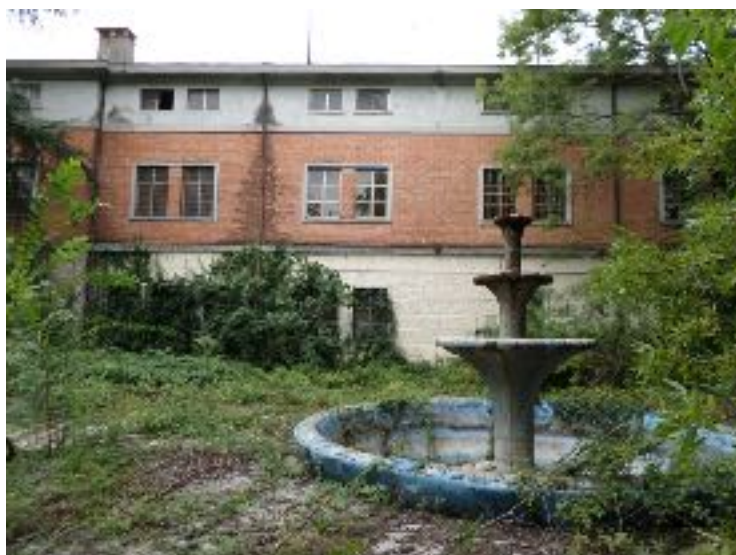
Figura 1 | Degrado e abbandono all'interno della caserma Trieste di Casarsa della Delizia. Fonte: fotografia di Federico Camerin
