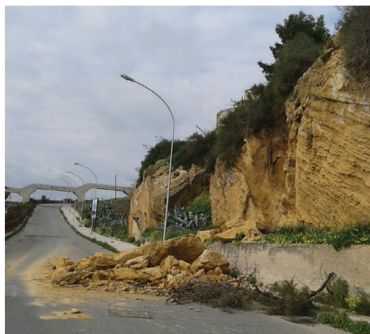
Figura 4 | Agrigento, Via Dante. Esito della frana del marzo 2015. Fonte: Foto dell'autore.
